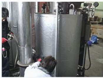
ボイラー遮熱（燃料費30%削減）
